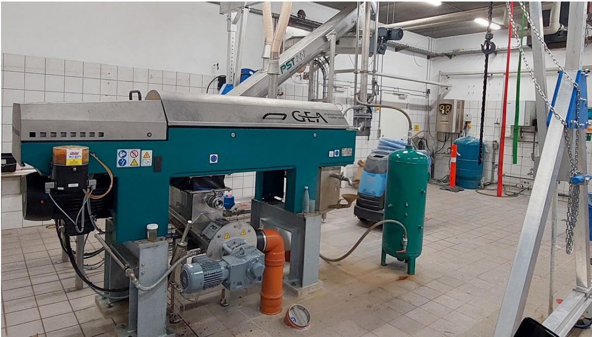
Dekanter-centrifugeinstallation på Stavnsholt Renseanlæg.
