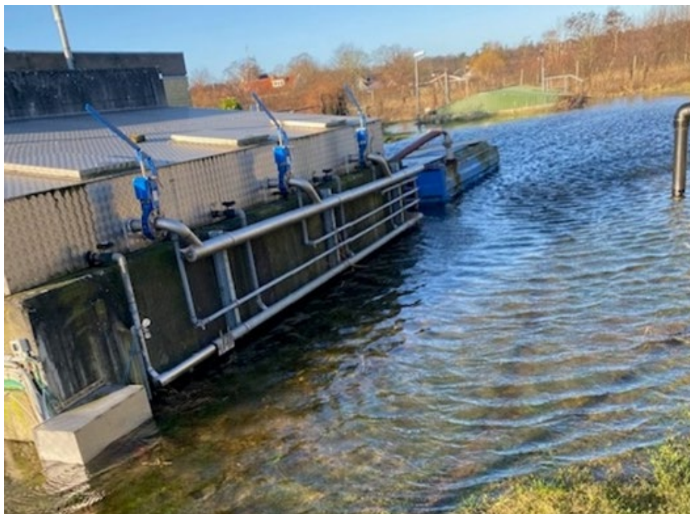
Neder Dråby Renseanlæg under vand under stormen Malik 30. januar 2022.
